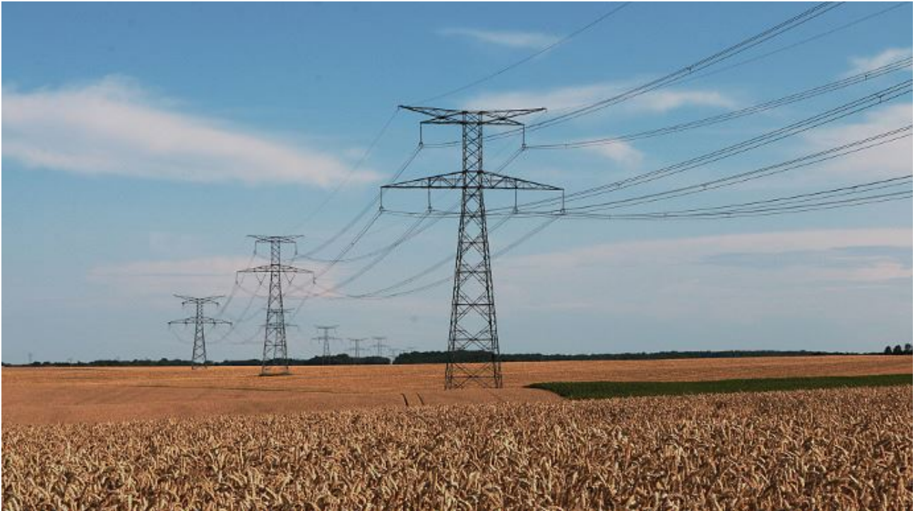
Les lignes haute tension qui traversent les parcelles représentent un danger mortel pour les agriculteurs. (@luctheo/Pixabay)
